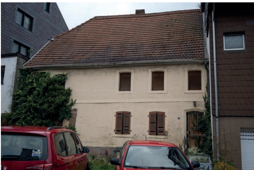
verfallendes Baudenkmal in der Kirchstraße / oberen Saarbrücker Straße
