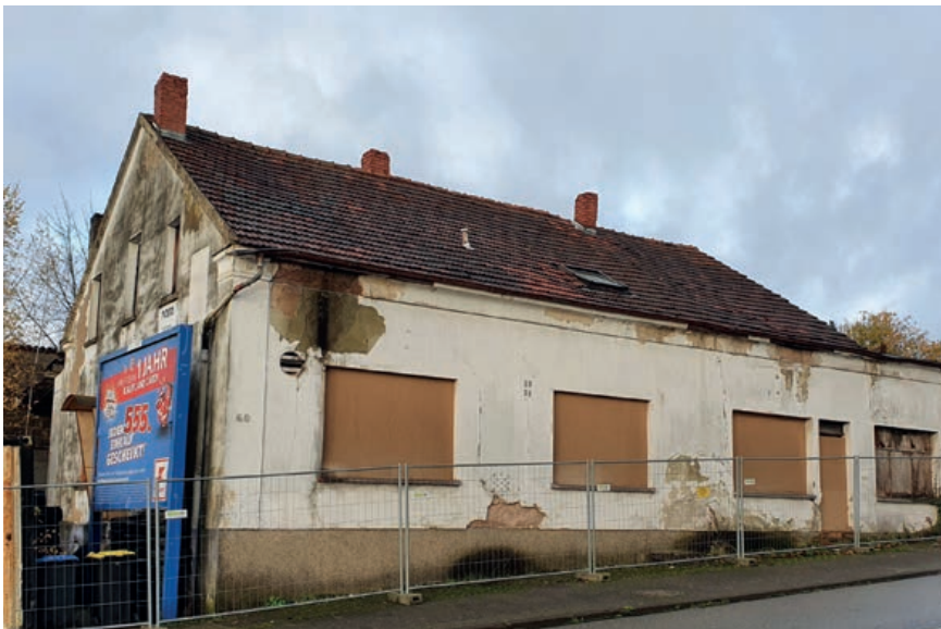
ortsbildbeeinträchtigendes Gebäude in der mittleren Saarbrücker Straße
