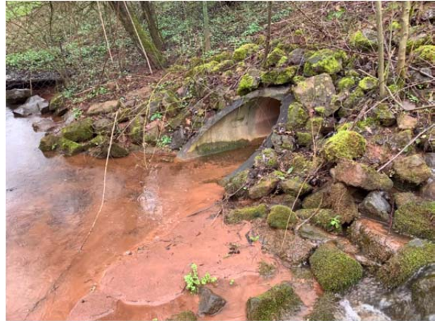
Abbildung 14: Zulauf Ost mittlere Kaskadenebene ZLP 2
