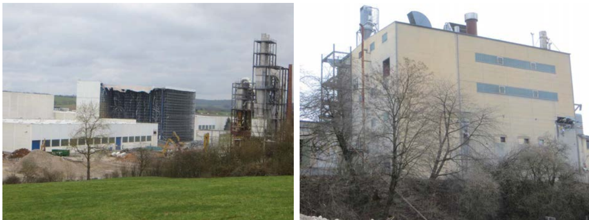
Abb. 5: derzeit (Mitte März) stattfindender Rückbau des Hochregallagers (links); noch rückzubauendes altes Heizkraftwerk (rechts) ohne von außen erkennbare Brut-/Quartiermöglichkeiten
