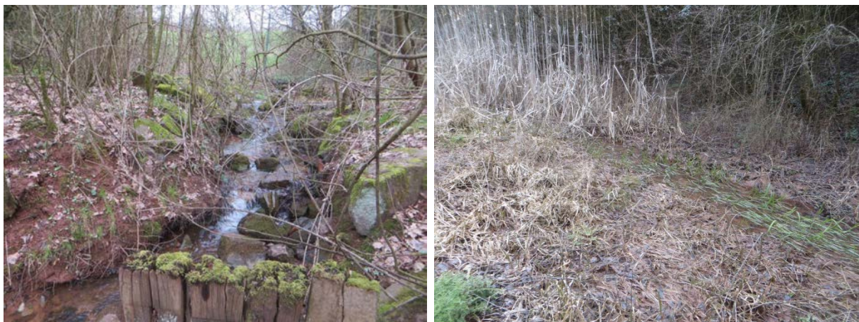
Abb. 11: mit Wasserbausteinen und Pfahlbuhnen gesichertes Auslaufgerinne aus dem verrohrten Quellbereich und der Bahnböschung ohne Stillwasserbereiche (links); flacher temporärer Durchfluss durch das RRB nach längeren Regenereignissen (rechts)
