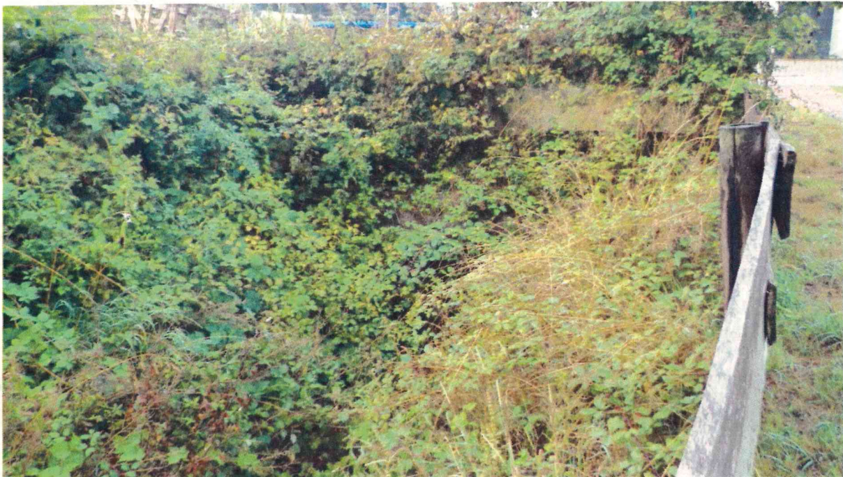
Verkrautung am Wahlbachdurchlass am 17.08.2020
